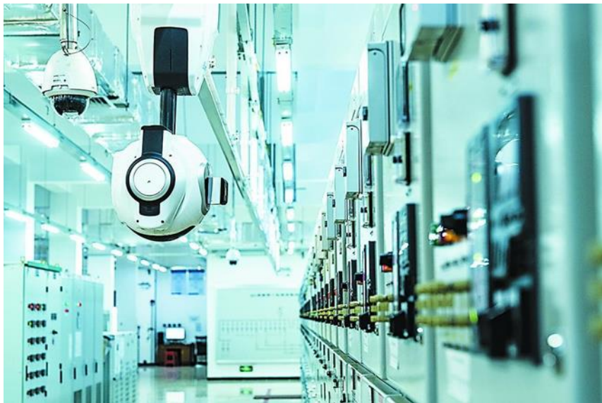
图 1 中科炼化乙烯装置配电室轨道巡检机器人在监控电流、电压、断路器运行状态及配电室温度、湿度等，实现配电设备全天候巡检、配电室异常状况的监测预警
